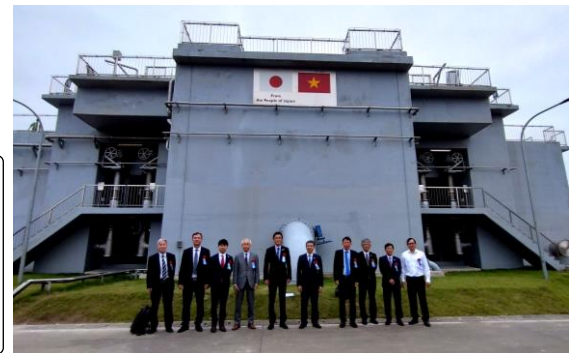
アンズオン浄水場U-BCF設備
