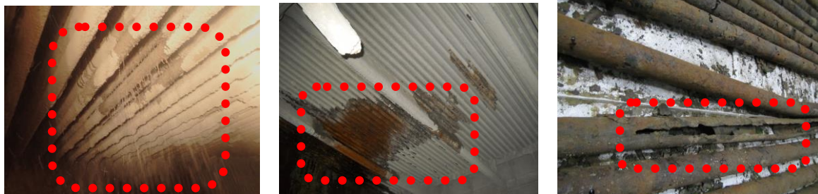
破損したボイラー水管の様子（左、中央は漏水時の様子、右は破損状況）
