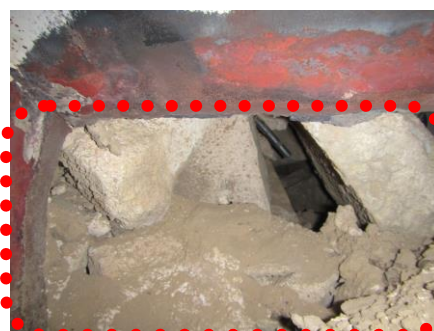
耐火物が脱落した際の内部状況
