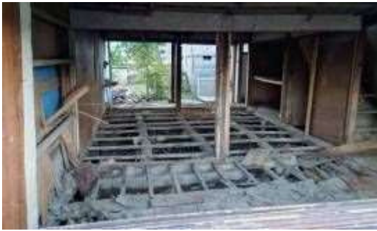
(河川北側の被災家屋例)
