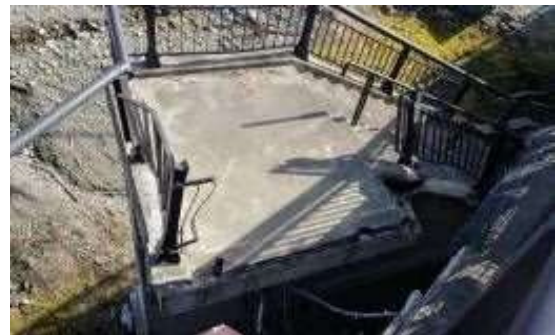
(基礎ごと橋脚から分断された連絡通路)
