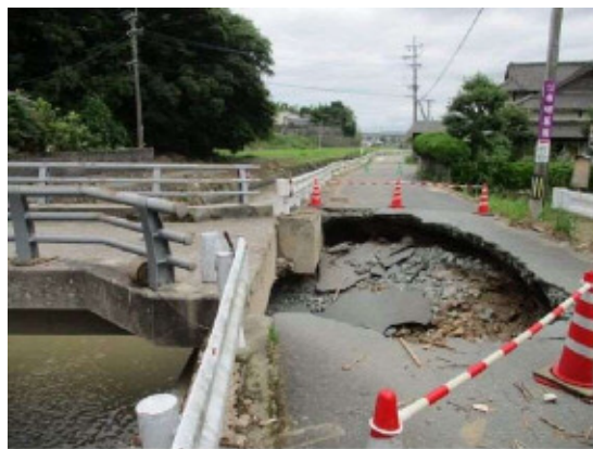
道路兼用護岸崩壊状況
