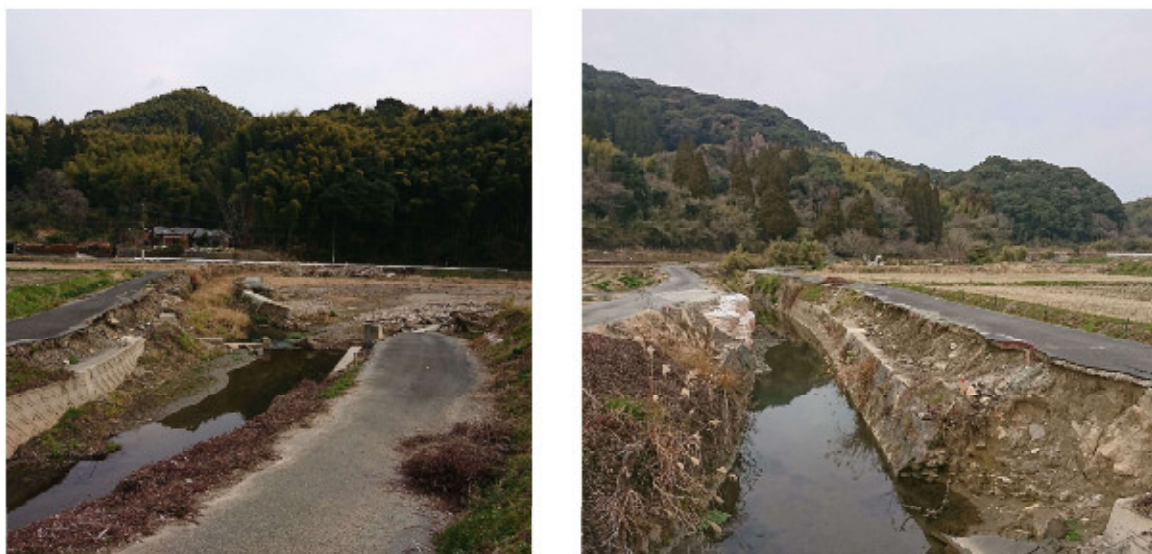
河川災害箇所
