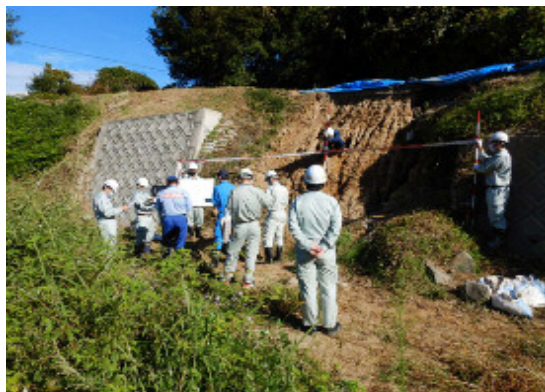
査定状況(道路)
