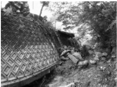
河川災 工種：大型ブロック積 被災時
