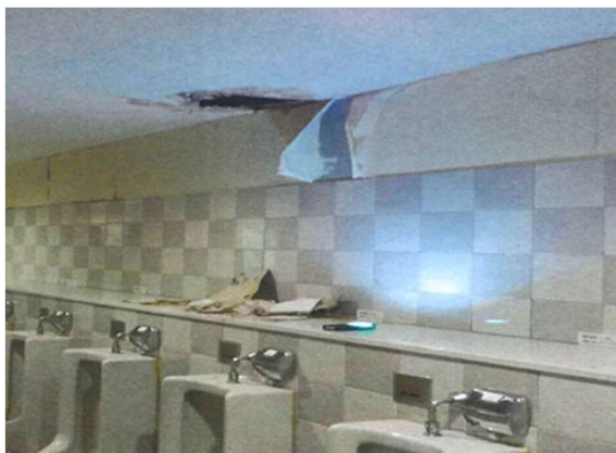
◇3階トイレ天井崩落
