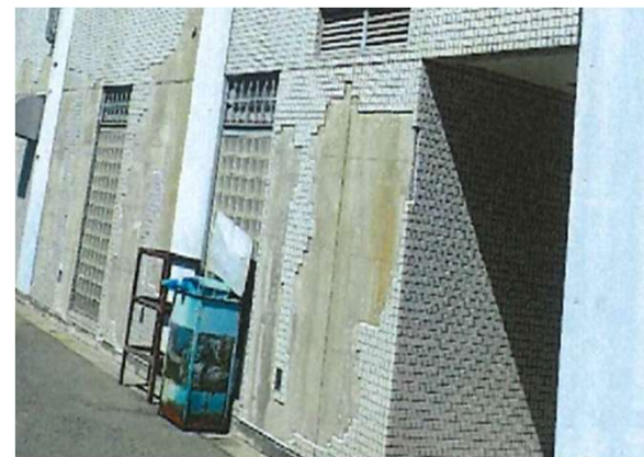
◇外壁タイル剥落
