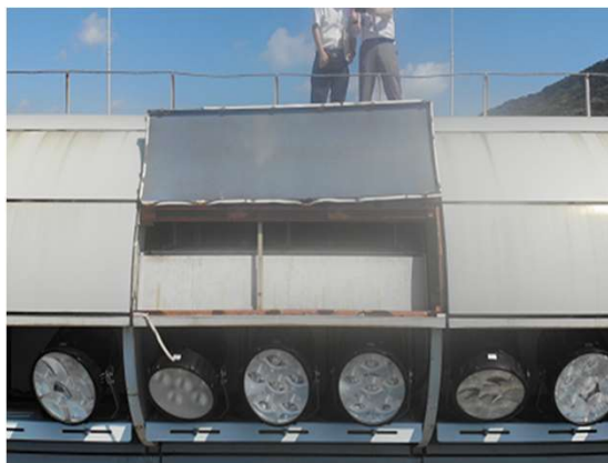
◇屋上外壁パネル破損
