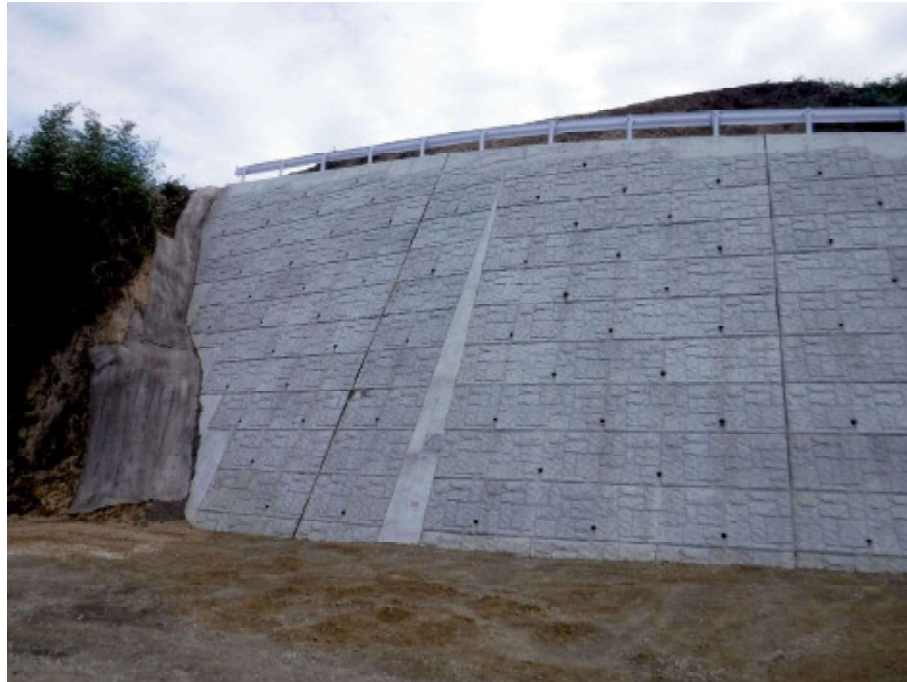
大型ブロック使用の擁壁 擁壁の上が被災道路（幅員は約4m） 上側下側の宅地はともに家屋は被災し解体されている
