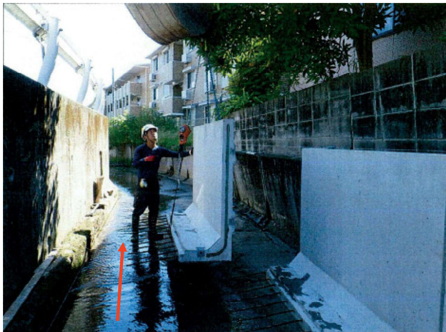
施工状況 右側既設護岸が傾いているのがわかる
