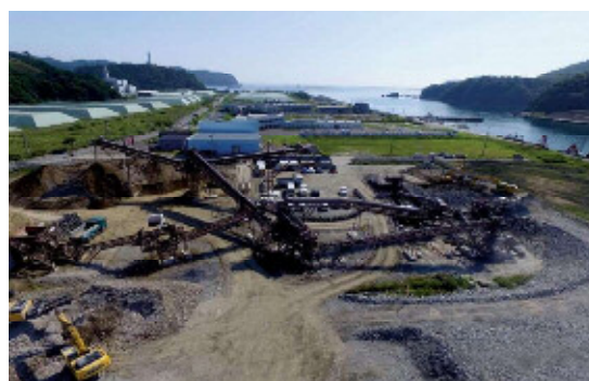
写真-2. プラント全景
