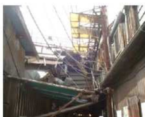
木造建物等の老朽化
