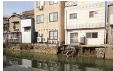
市場対岸側の護岸の崩落 (H26年3月)
