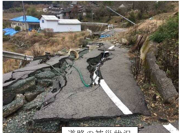
道路の被災状況
