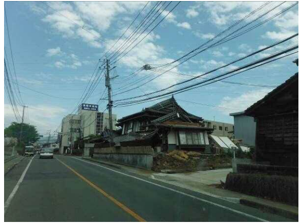
【東熊本病院東側（福富）】 隊員がブレーカーを落とした家屋
