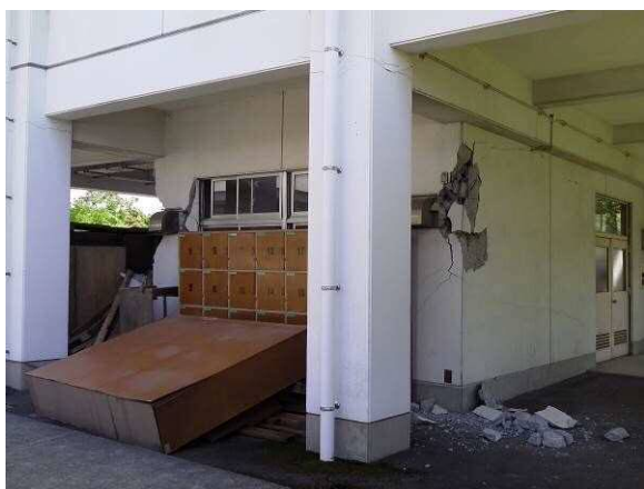
【熊本県消防学校の状況】 柱にも亀裂が入っている
