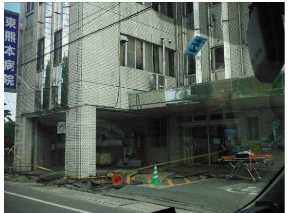
【東熊本病院（中惣領）】 地上が隆起している
