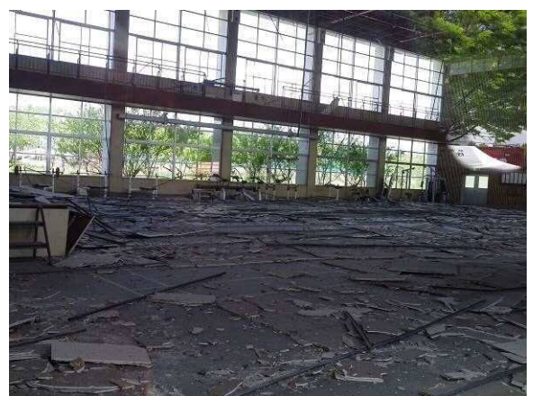
【熊本県消防学校体育館の状況】 天井のパネルが全落下している
