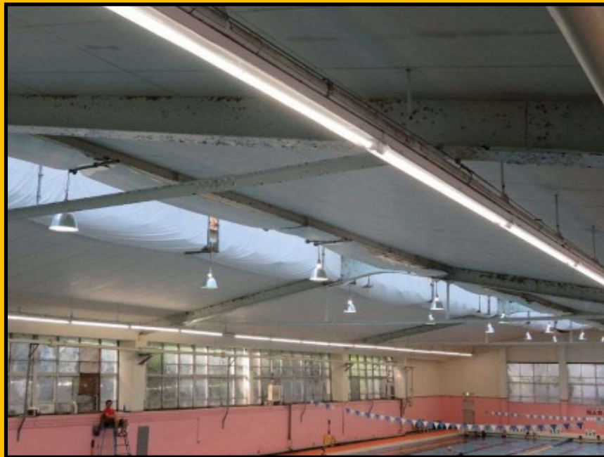
【老朽化した室内プール】
