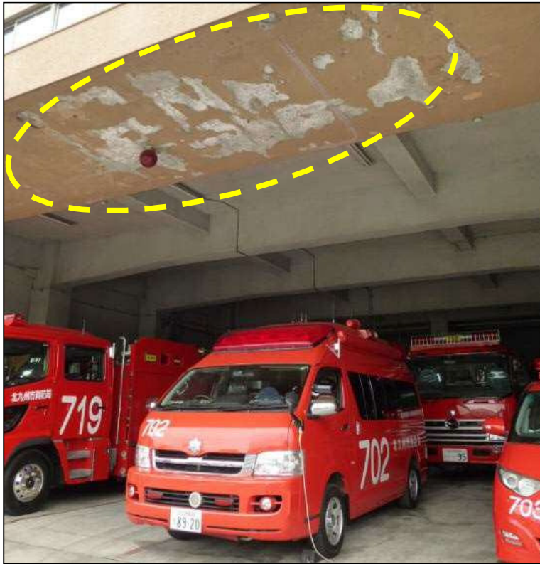
【ひさしの劣化】
