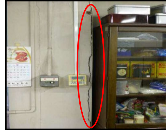
【柱の亀裂(待機室)】
