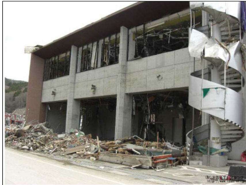
【東日本大震災で被災した消防署】
