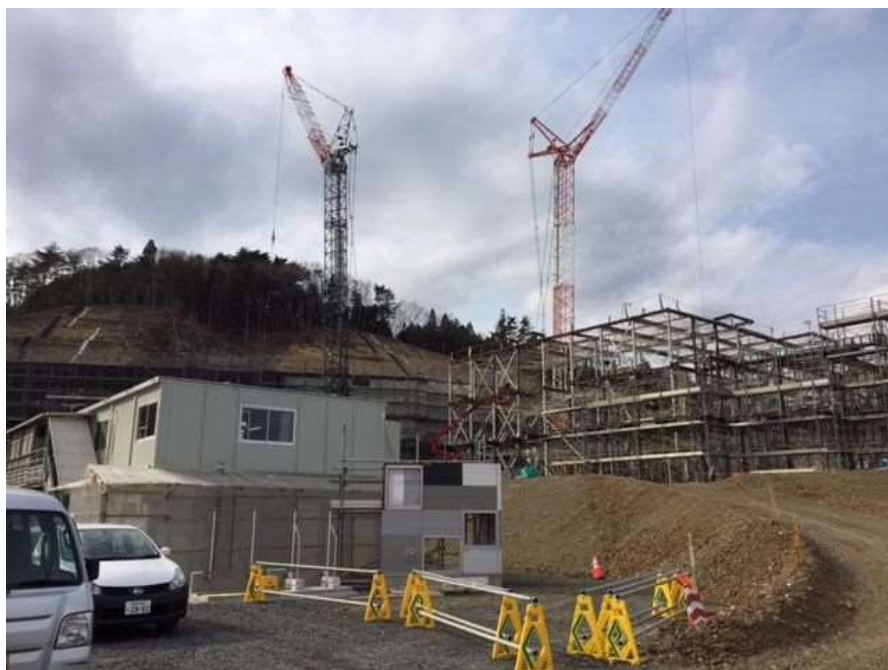
鶴住居小中学校建設状況（平成 29 年 3 月竣工予定）平成 28 年 3 月撮影
