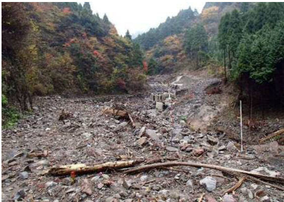
写真-1 被災後写真(道路・河川)
