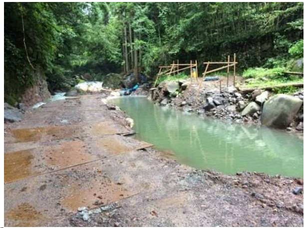
写真② 現場の浸水
