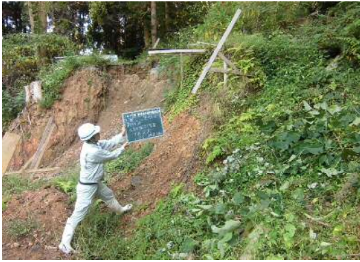
道路災害（石原・鹿子生線）着手前
