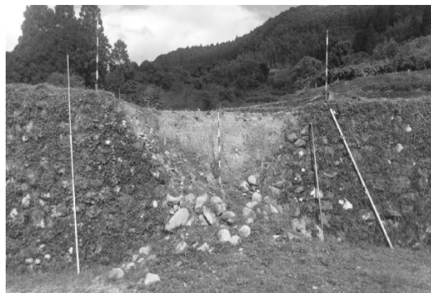
【被災状況写真（田）】
