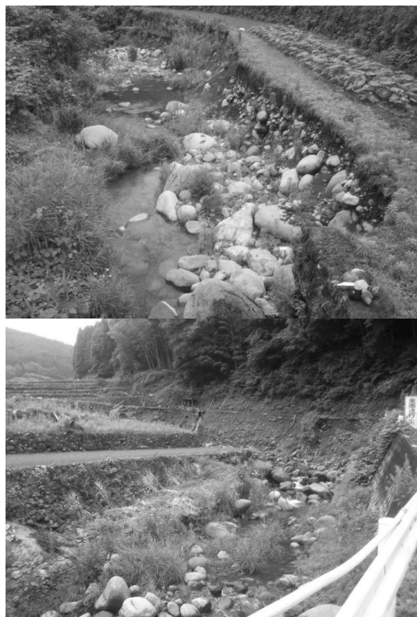
(石積護岸が崩壊した様子)
