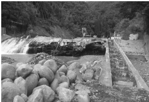
【被災状況写真（頭首工）】
