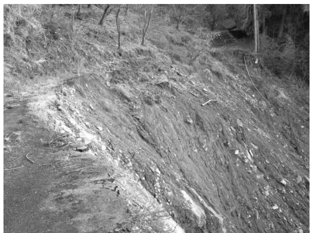
図-2. 被災箇所の状況
