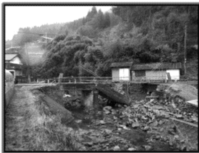
写真-②被災状況 (白土橋)
