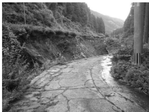
写真-1 被災現場（中の小路川）
