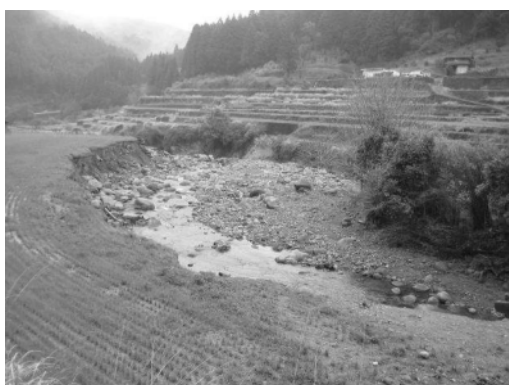
【 持木川 被災箇所 】
