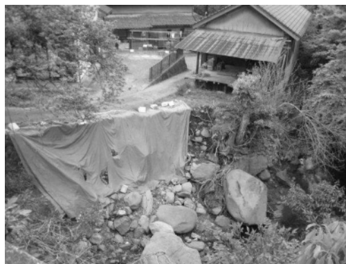
【護岸被災 近くに納屋と住宅】
