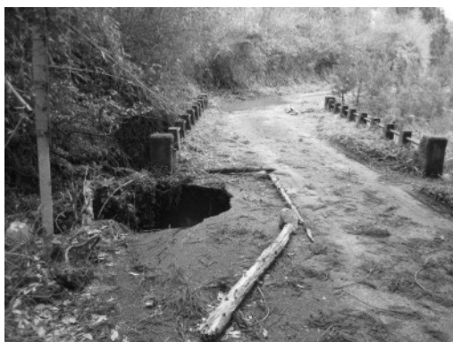
【橋梁横の護岸被災 道路の陥没】
