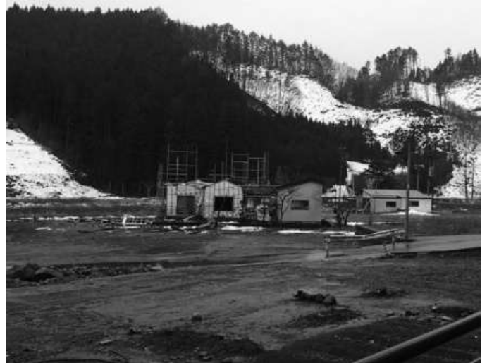
本郷地区高台移転先の盛土造成工事のため 移転が決まり解体中の家屋
