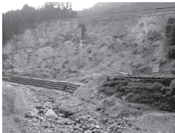
【八女市黒木町の土砂崩れ】
