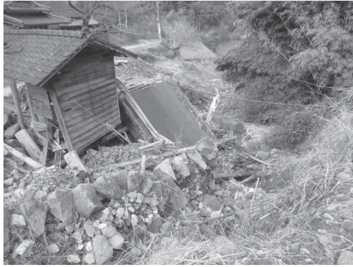
【被災箇所一例】
