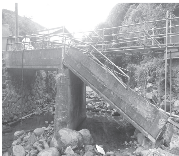
【河川増水して橋梁が落橋した箇所】
