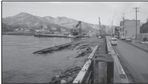
地盤沈下によって水没した岸壁
