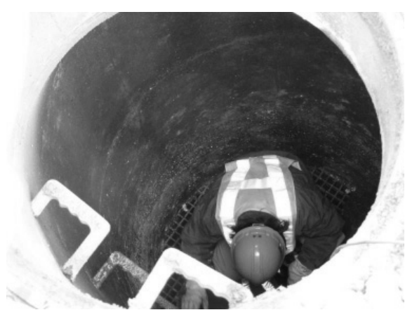
4月3日 ⑥下水道管渠第二次調査 ※人孔内部の被災状況調査（業者対応）
