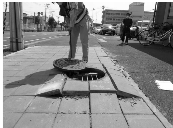
4月14日 ⑫下水道管渠0次調査 ※地盤の液状化現象による人孔の隆起
