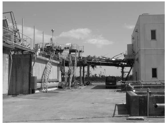
4月13日 ⑪仙台市南蒲生浄化センター被災状況 ※巨大津波により水没し、処理機能停止
