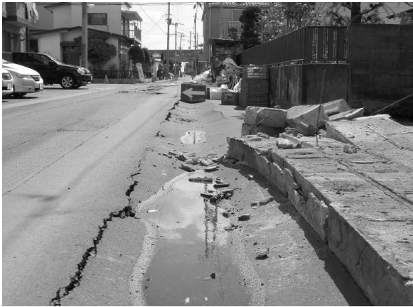
4月12日 ⑧下水道管渠第二次調査状況 ※管布設箇所の道路陥没（ブロック塀の倒壊あり）
