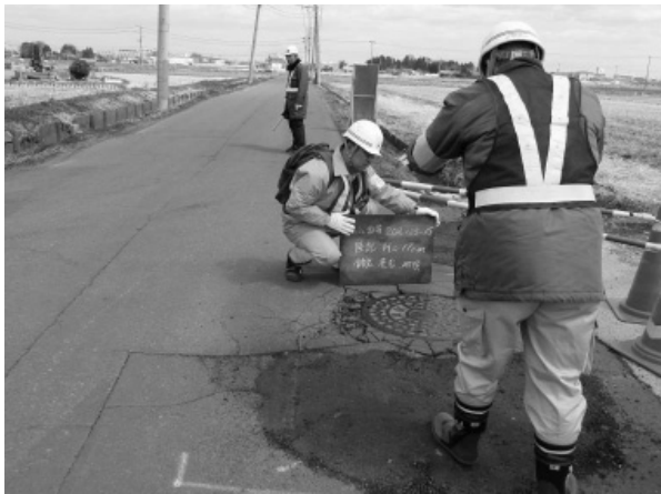
4月3日 ②下水道管渠第二次調査 ※人孔被災状況の写真撮影
