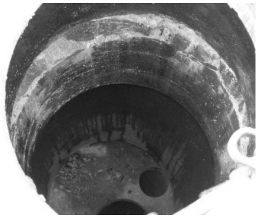
4月3日 ⑤下水道管渠第二次調査 ※人孔内部の被災状況（受枠のズレ）
