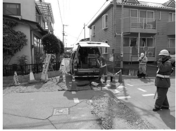
4月12日 ⑩下水道管渠の第二次調査 ※ テレビカメラ調査状況
