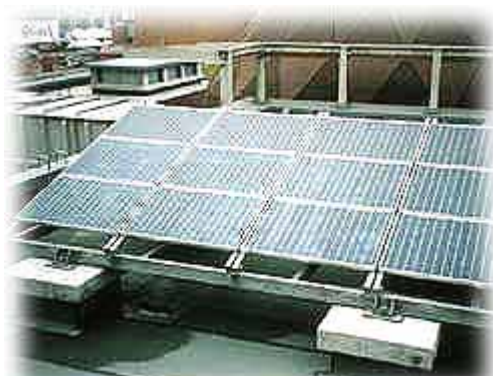
太陽光パネル
