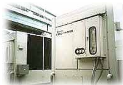
氷蓄熱空調システム
