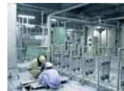
汚水処理設備
